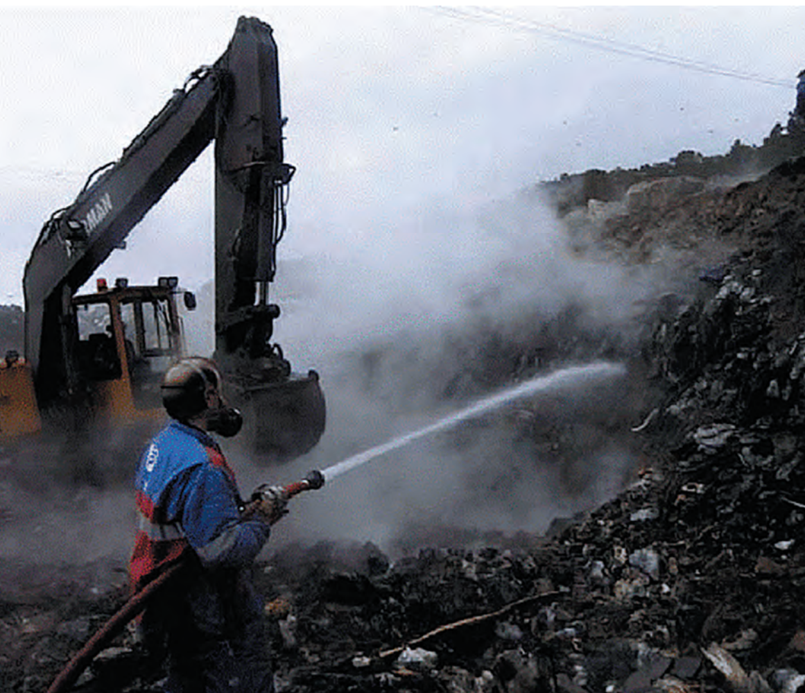
Рис. 11. Работы по выемке горящего грунта и охлаждению водой, февраль 2005 г. Источник: https://www.researchgate.net/figure/The-fire-was-put-out-by-excavation-and-subsequent-cooling-by-use-of-water-Protective_fig3_7735850
