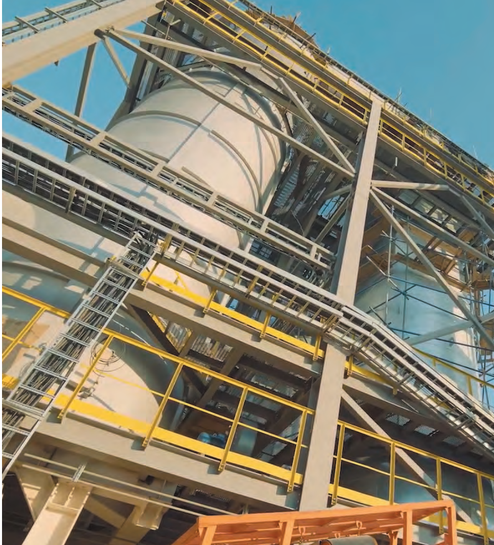
Рис. 3. Установка термического обезвреживания отходов
